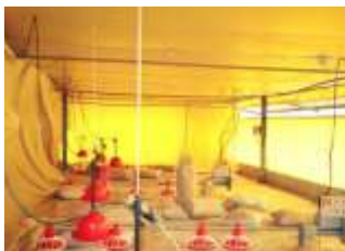
Foto 02 Ponto de entrada do ar no sistema de ventilação mínima para renovação do ar interno do galpão
