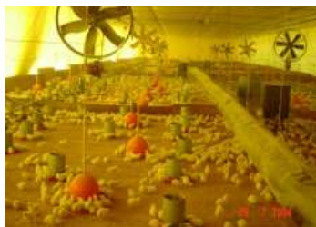
Foto 06 Lonil (tubo) para distribuição do ar aquecido
